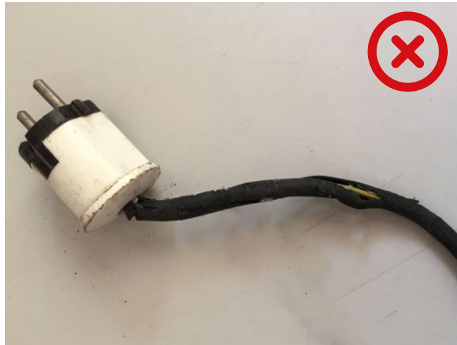
Abb. 4 Lebensgefahr durch ungeeignetes Arbeitsmittel mit defekter Isolierung
