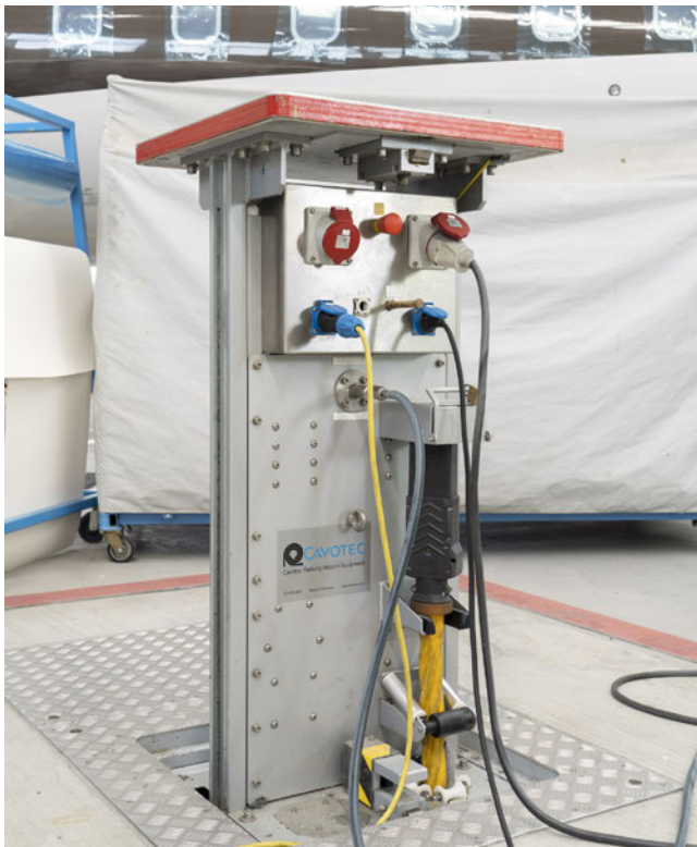
Abb. 66 Bodenhydrant für elektrische und pneumatische Anlagen im Hangar
