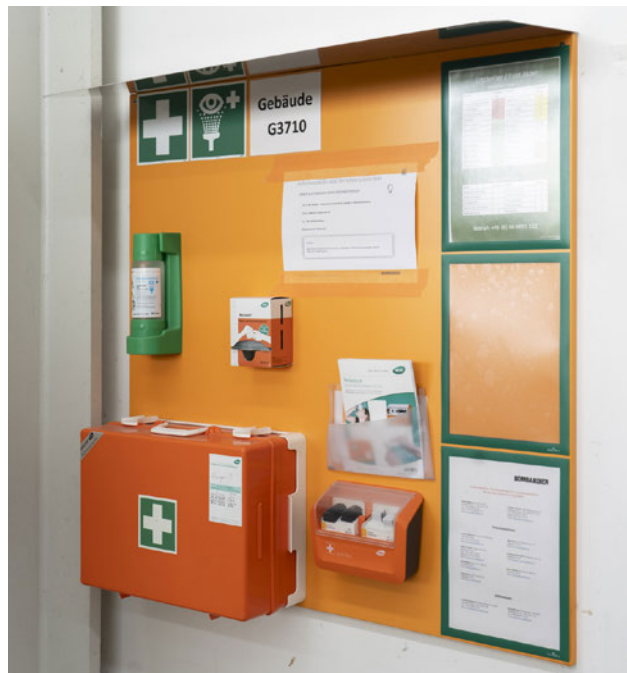
Abb. 41 Kurze Wege zu gebrauchsfertigen Einweg-Augenspülflaschen ermöglichen im Notfall schnelle Hilfe
